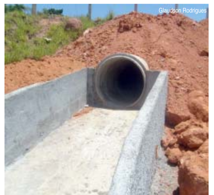
O local foi prejudicado em função das chuvas, o que deve ser evitado com a instalação da calha
